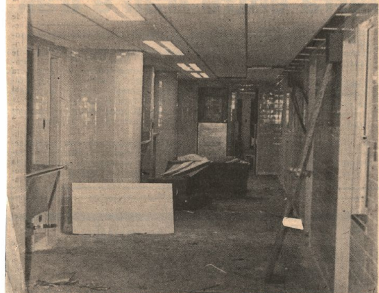
En este piso se están instalando los seis quirófanos. El diseño y construcción de este nivel permitirá al hospital ser uno de los más bien dotados en el campo quirúrgico.
